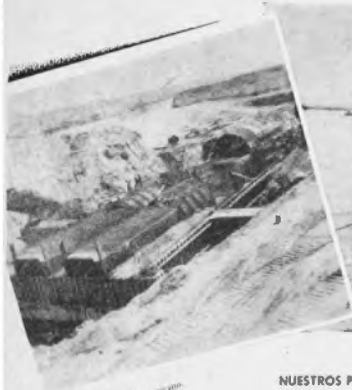
Obras de acero del lado mexicano Vista hacia aguas abajo monente de varilla corrugada.
