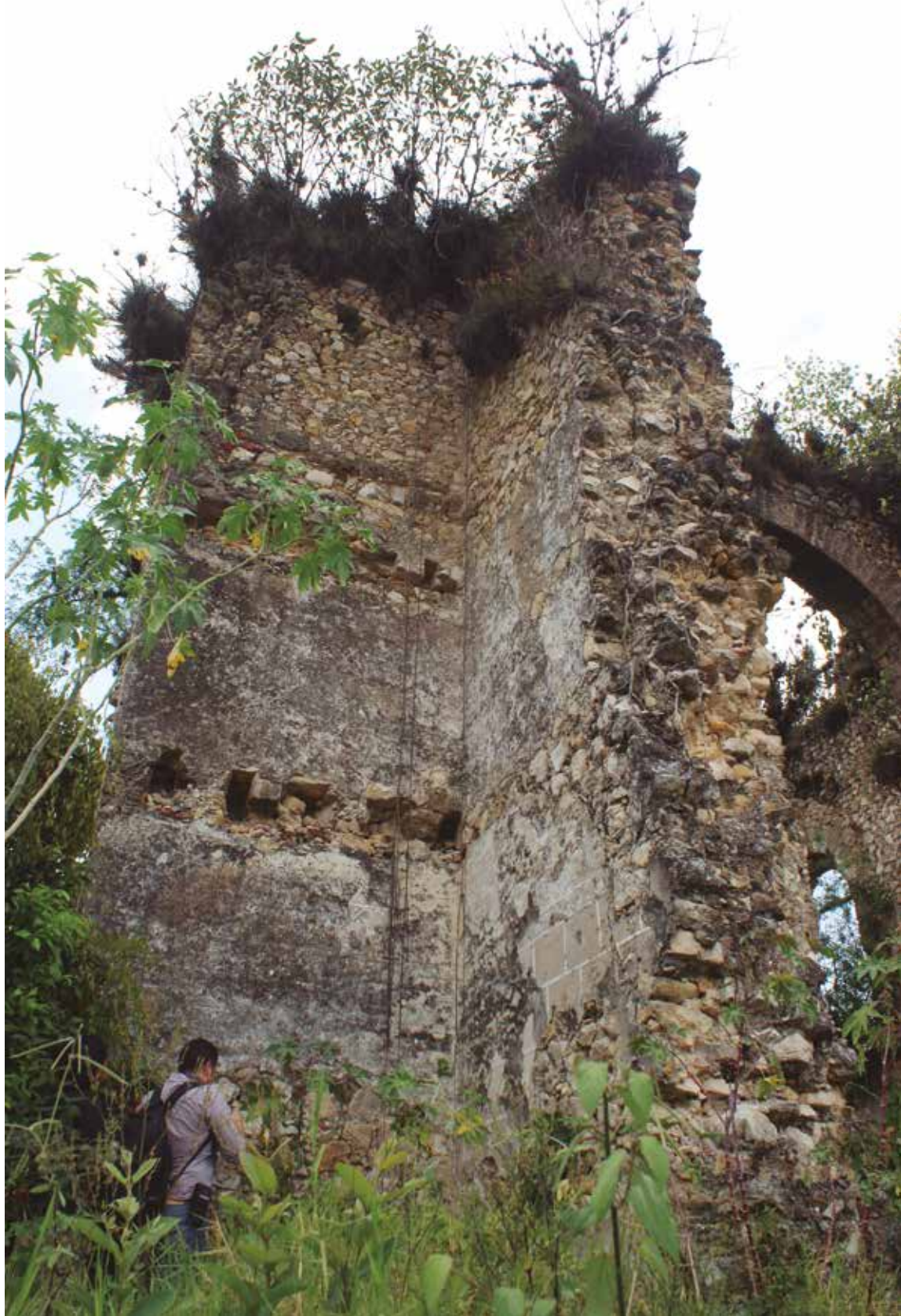
IMAGEN 49. Muros colindantes de la sacristía con el templo, San Marcos Sibaoá, 5 de abril de 2012. © Magdalena Vences.
